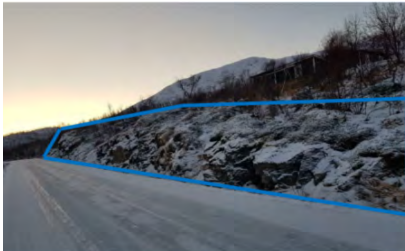
Berg i dagen på oversiden av veien øst for området er markert i blått.
